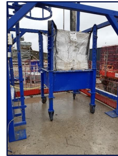
Figure 2 : Bac de récupération des laitances de béton d'une tour de lavage (Source : SAFEGE, 2022)
